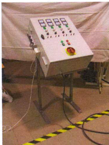
Obr. 13: Elektrický rozvaděč pro napájení mobilní spalovací jednotky
